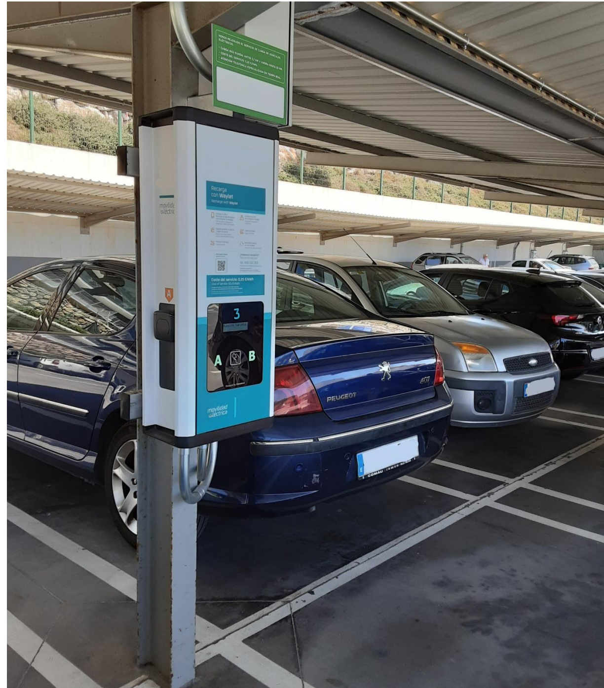
Figura 41. Fotografía del aparcamiento aprovisionado con punto de recarga.
